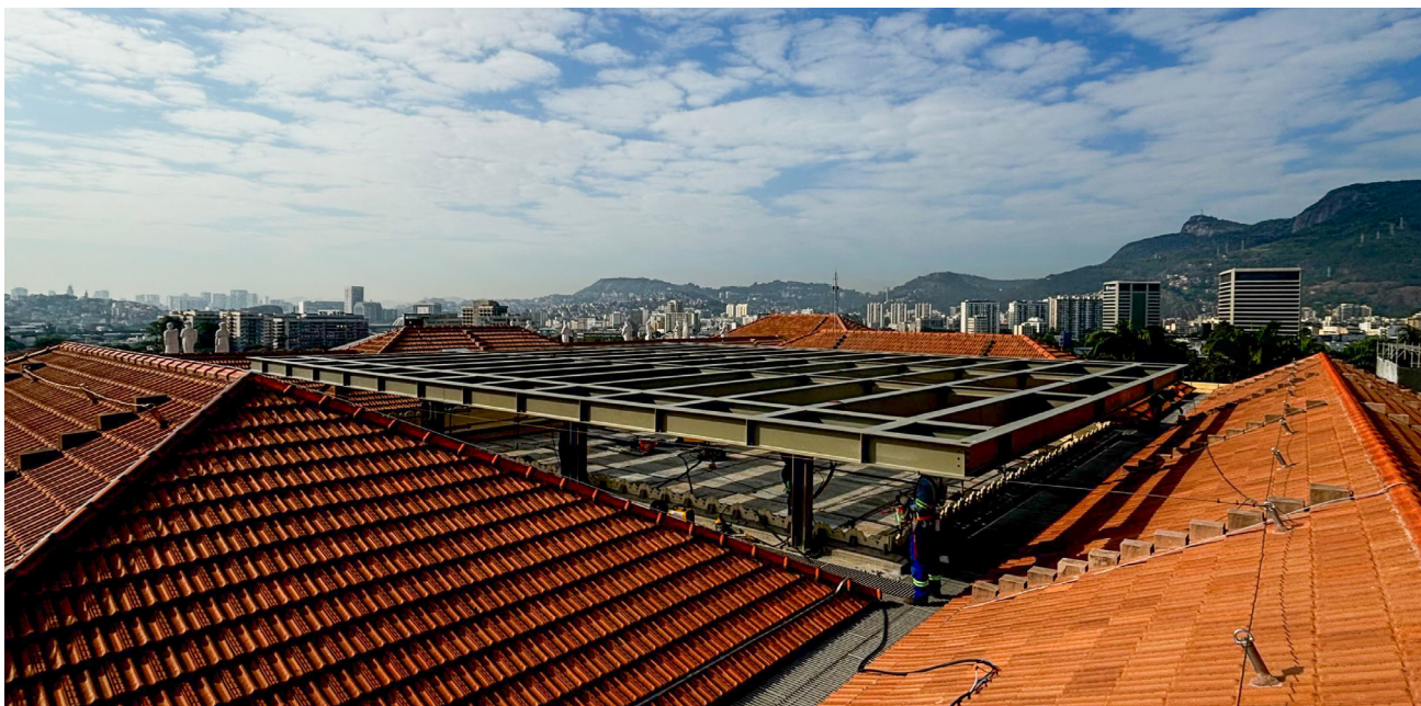
Imagem panorâmica da claraboia, uma das inovações do projeto de arquitetura e restauro
